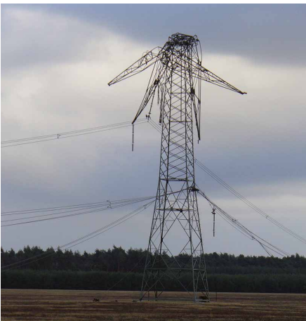
Sturmschaden durch den Orkan Kyrill im Jahr 2007
