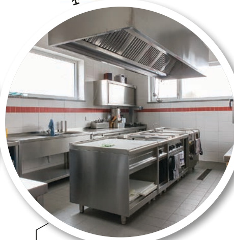
Küche zur Mannschftsverpflegung und Versorgung bei Großschadenslagen
